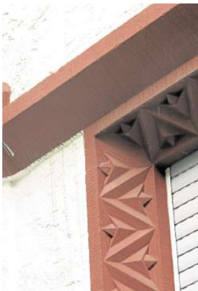
Mit viel Liebe und großer Handwerkskunst wurden Gesimse und Balken an Fenstern gestaltet. Plastikrollläden der Neuzeit nehmen diesen sehenswerten Details den Charme.
